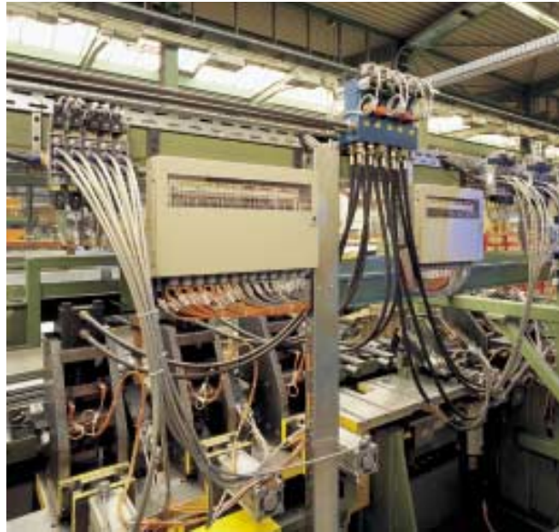
In dezentralen Klemmenkästen sind Sensoren und Aktoren an die Busklemmen angeschlossen; die Datenübertragung an den Zentralrechner erfolgt per Lightbus
