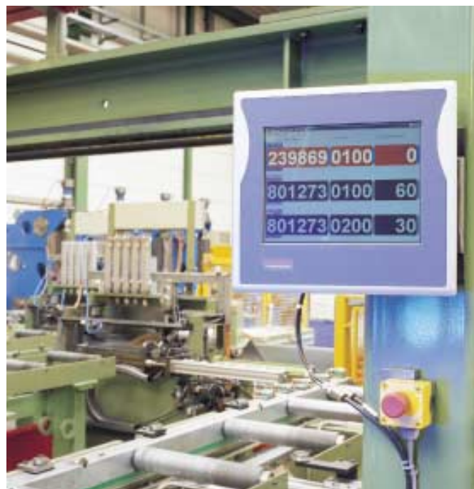
Den aktuellen Fertigungsstatus zeigt das Control Panel direkt an der Anlage an, er ist mit dem Industrie-PC über bis zu 65 m lange Koaxialleitungen verbunden
