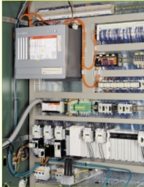
Abb. 1: Die Steuerungszentrale bestehend aus Industrie-PC und Lightbus I/O-Baugruppen
